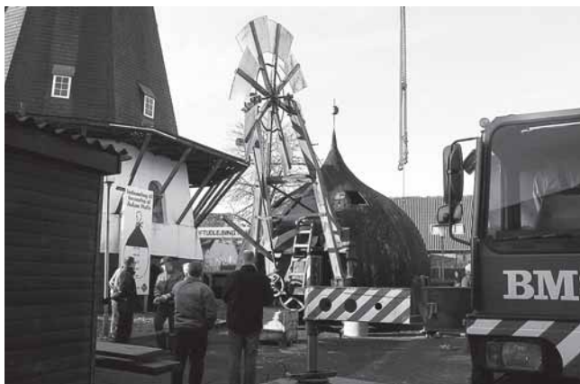
Møllehatten er kommet tilbage efter endt renovering og venter på at blive løftet på plads.
